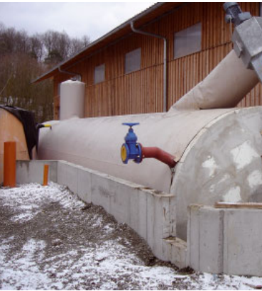
cuve de méthanisation
