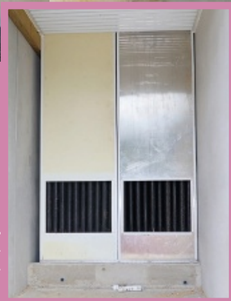
Un échangeur de chaleur récupère les calories de l'air sortant pour les transférer à l'air entrant. ©Ifip
