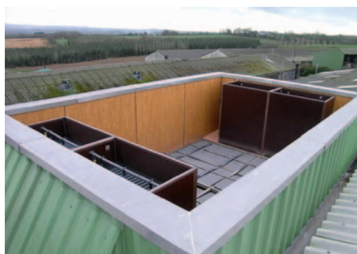
Echangeurs en toiture
