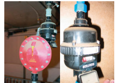
Figure 5 : Compteur d'eau « mécanique » installé à chaque case
